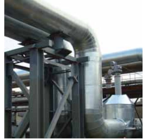
Impianti di climatizzazione.
