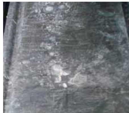
Le tracce bianche dovute alla formazione di carbonato basico idratato non influenzano la resistenza alla corrosione e sono il risultato della cosiddetta protezione galvanica.
