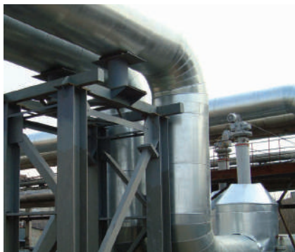
Impianti di climatizzazione air-conditioning systems
