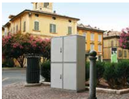
Distribuzione elettrica Electrical distribution
